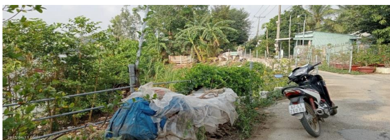
Hình ảnh đoạn từ KM3+000 ÷ KM4+600 sạt lở ngày 19/9/2024, đã gia cố tạm thời
