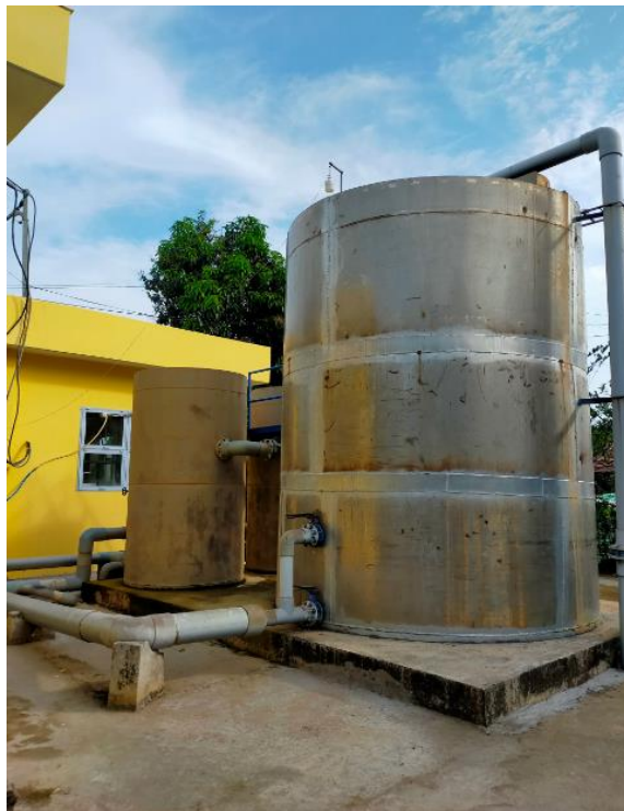
Hình. Bể lắng nước
