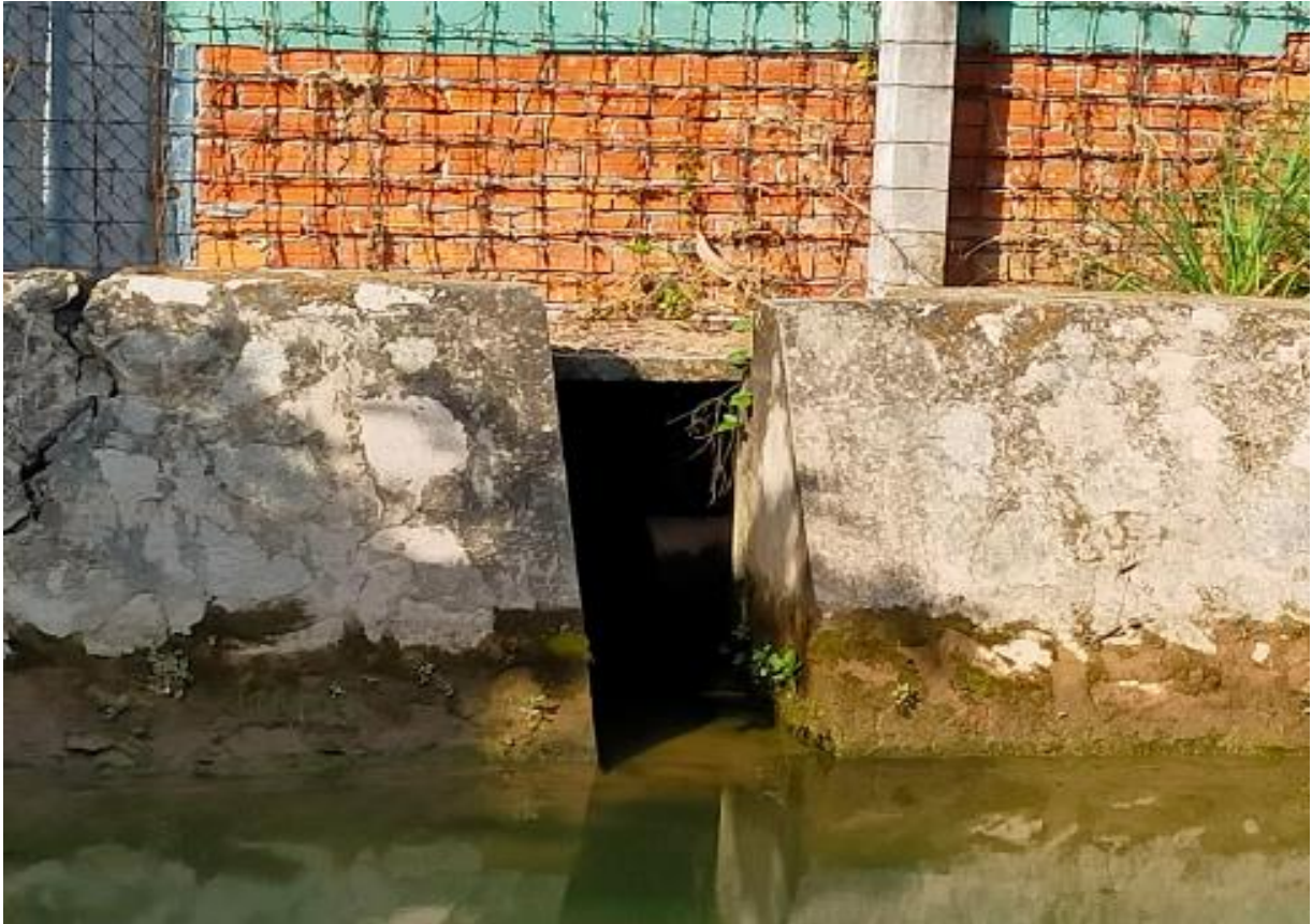
Hình 10. Cống thoát nước thải
